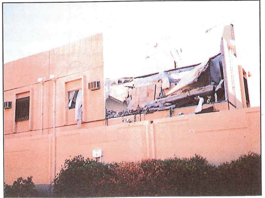
● تصدع نتيجة لانفجار سخان مياه .
